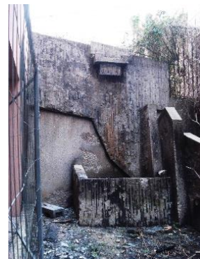
La cascade entre le 46 et 62 de l'allée, dans un triste état d'abandon
